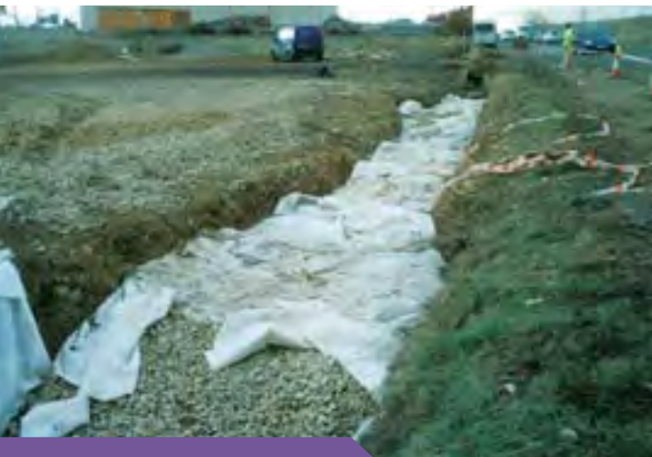
Cinturón de drenaje.
