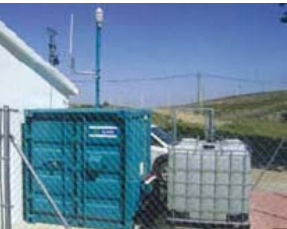
Estación meteorológica y antena GPRS.
